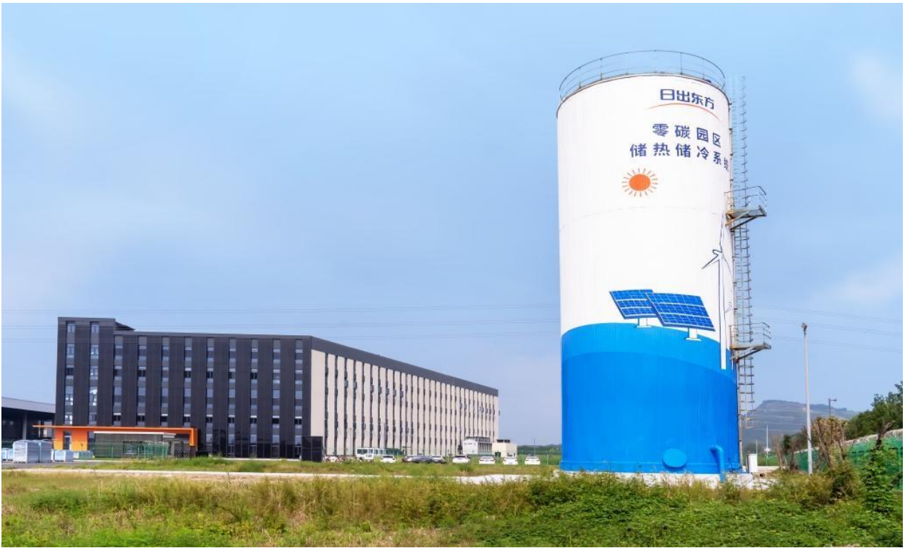
图表14：连云港基地大型储热储冷钢罐
