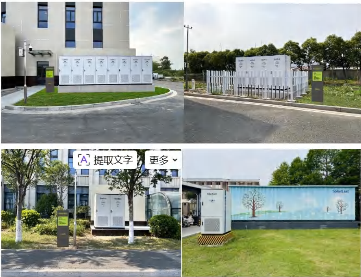
图表13：园区储能柜实景
