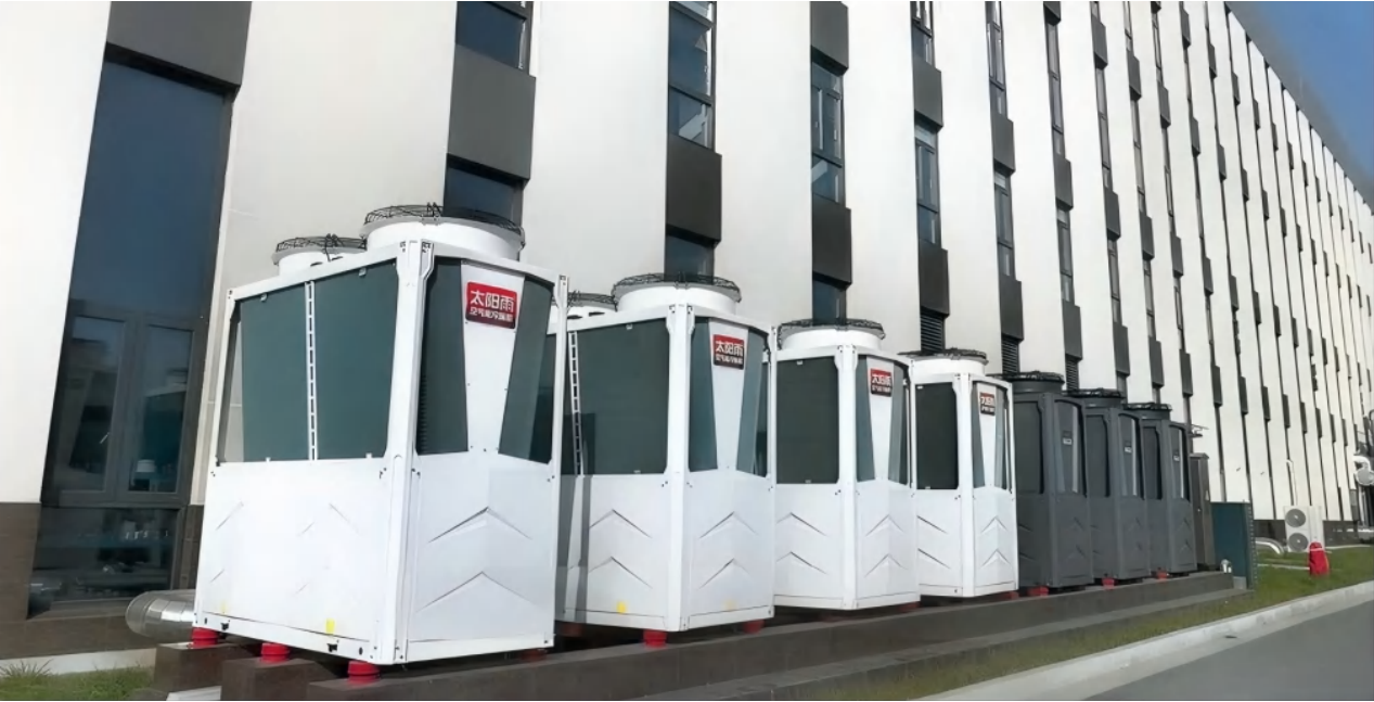
图表12：零碳大楼7台181kW变频空气源热泵
